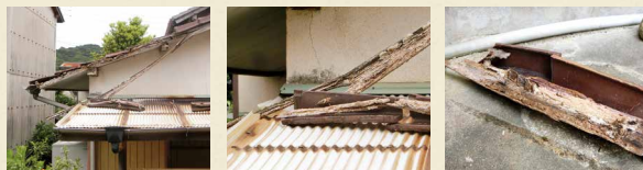
「台風で瓦が飛ばされたという保険請求でしたが、実際は屋根下地の木材が腐ってぼろぼろでした。聞けば以前から雨漏りがしていたとのこと。」
