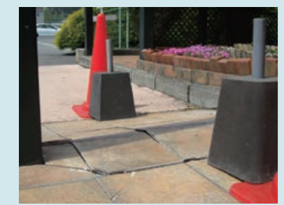
地震で浮かび上がった歩道のタイル
