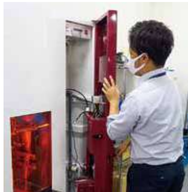
取材時には給水機システムの中身を見せていただきました
