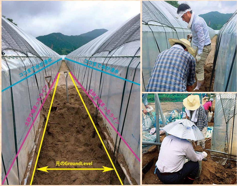
青が浸水ライン、紫が土砂で埋まったライン 上/下/手と手を取り合い、作業が進みます
