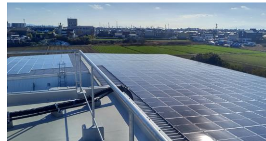
社屋屋根に設置されているソーラーパネル
